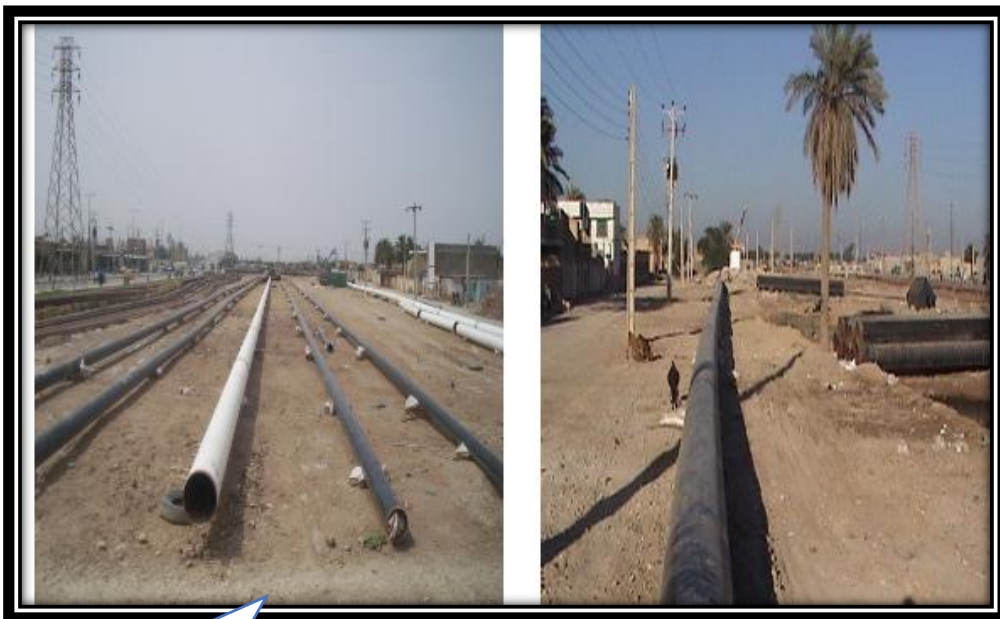
لوله ریسه شده و جوش خورده
